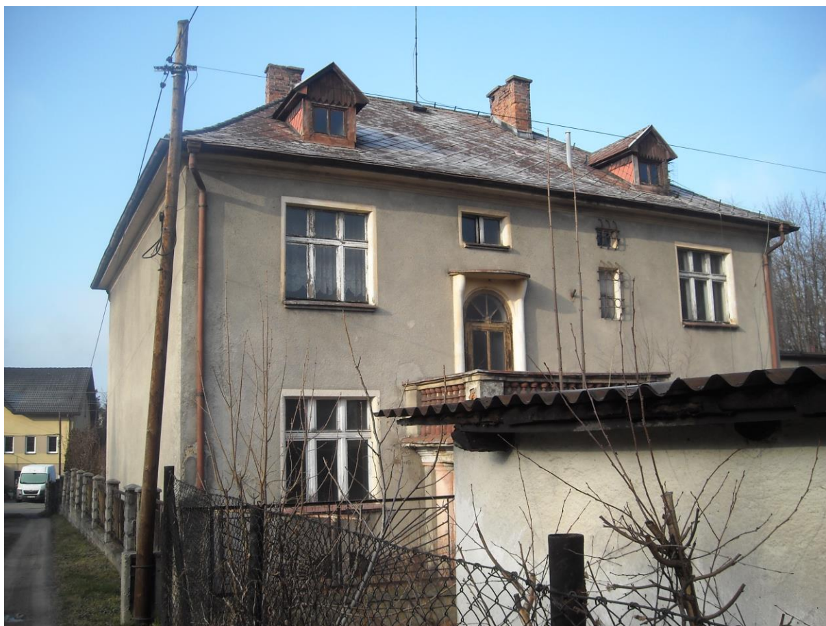
Rysunek 8 Dach pokryty płytami azbestowymi płaskimi (budynek przykładowy)
